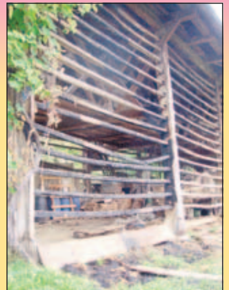
Požar na Paplerjevi ulici so gasilci pogasili še pravočasno.
